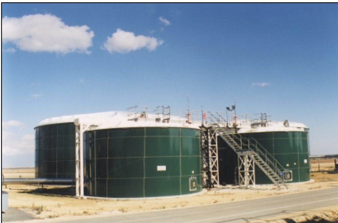
Δεξαμενές πάχυνσης της λάσπης και αερόβιοι χωνευτήρες
