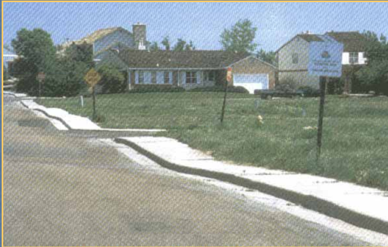
Δρόμος κατασκευασμένος σε διογκούμενο έδαφος
