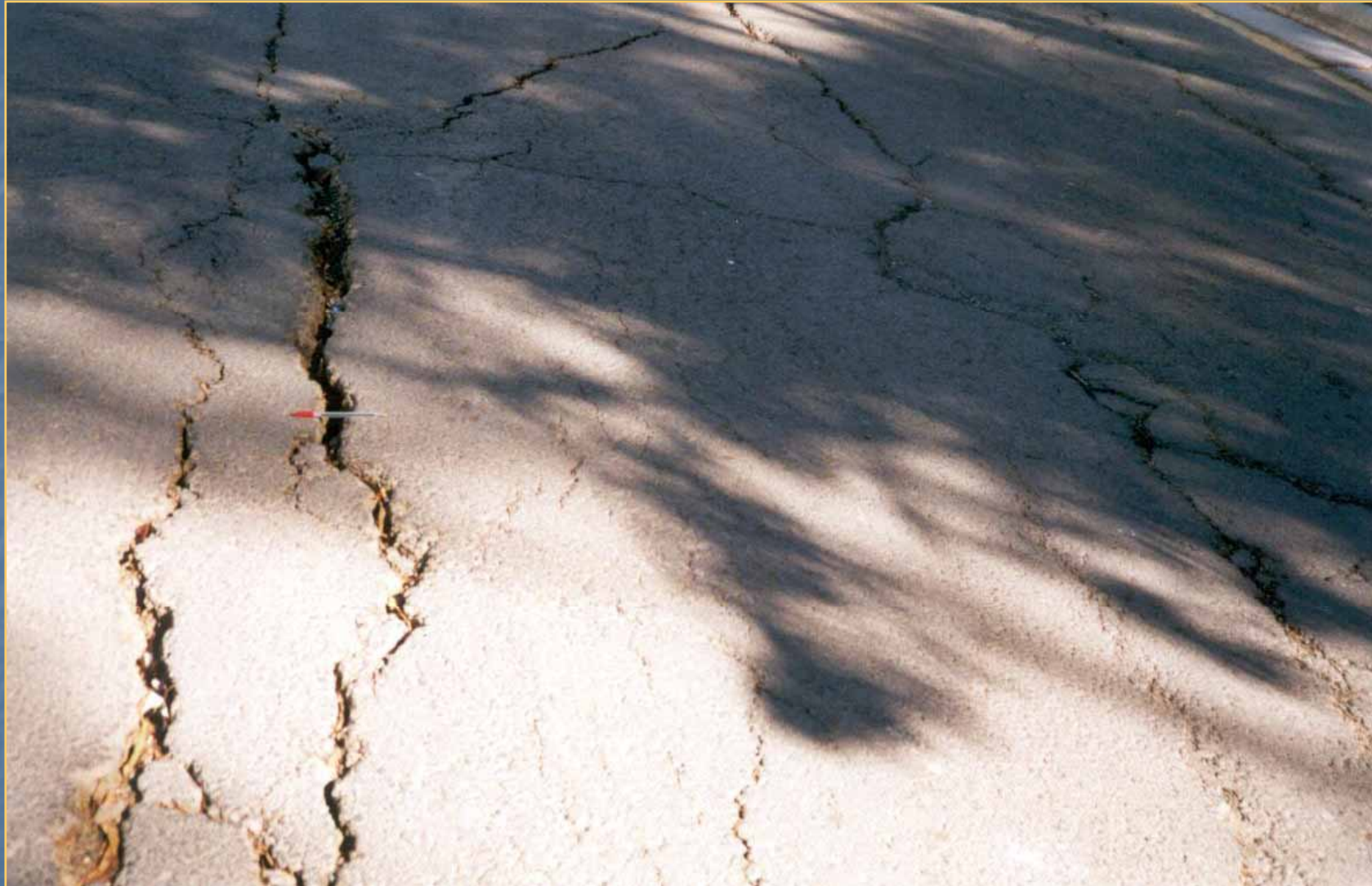
Μορφή ρηγματώσεων στο οδόστρωμα
