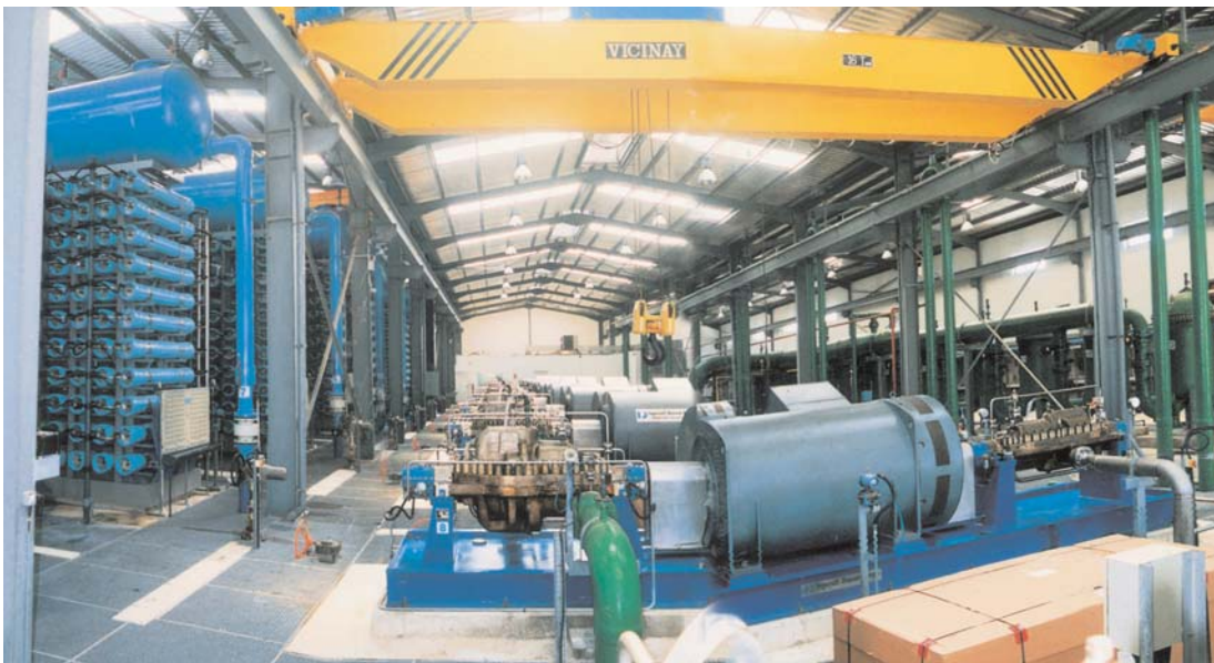
Μονάδα αφαλάτωσης Δεκέλειας (Φώτο: Αρχείο Τμήματος Αναπτύξεως Υδάτων)
