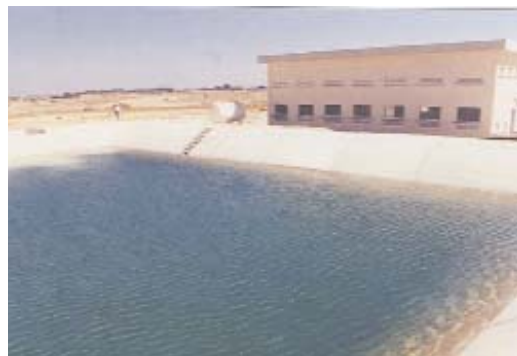
Σχέδιο Νότιου Αγωγού. Δεξαμενή και αντλιοστάσιο για άρδευση στην περιοχή Κοκκινοχωριών (Φώτο: Αρχείο Τμήματος Αναπτύξεως Υδάτων)
