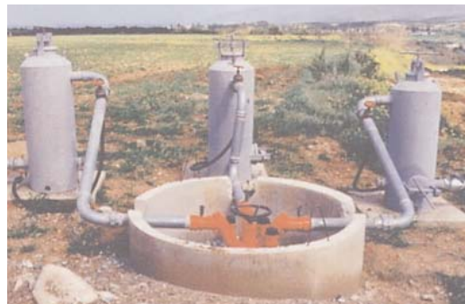
Αρδευτικό έργο Χρυσοχούς. Τριπλή παροχή (Φώτο: Αρχείο Τμήματος Αναπτύξεως Υδάτων)
