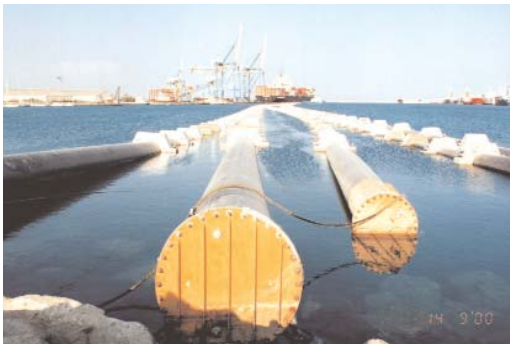
Τοποθέτηση σωληναγωγών στη θάλασσα κατά την εκτέλεση των κατασκευαστικών έργων της μονάδας αφαλάτωσης Λάρνακας (Φώτο: Αρχείο Τμήματος Αναπτύξεως Υδάτων)
