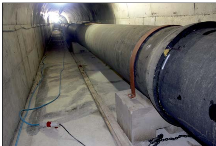
Αγωγός άρδευσης και εκκένωσης στον οχετό εκτροπής - Irrigation and scour pipe
