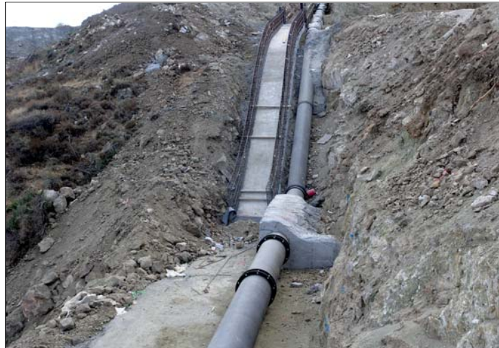
Αγωγός άρδευσης - Irrigation pipe
