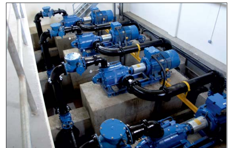
Εσωτερικό Αντλιοστασίου - Pumping station
