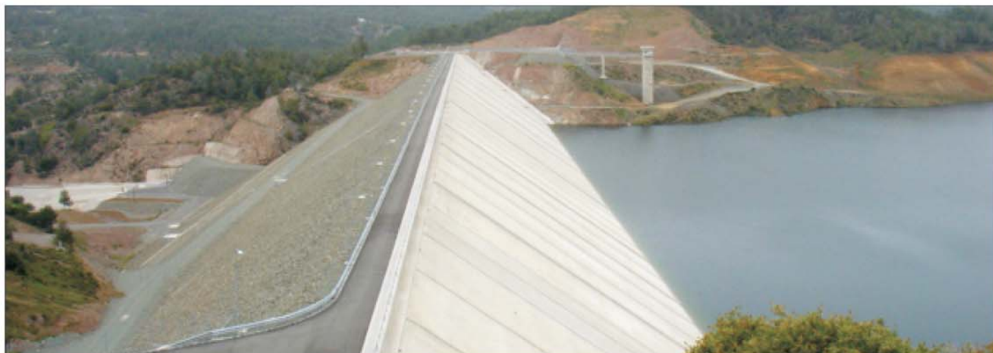
Γενική όψη στέψης φράγματος και ανάντη πλάκας - General view of crest and upstream concrete face
